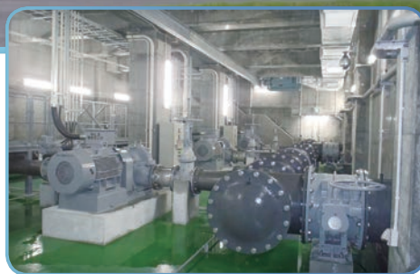
勇振ポンプ場内には、Φ300mmのポンプが3台設置され、1日約4万トンを高丘浄水場に送水する能力を有しています。
